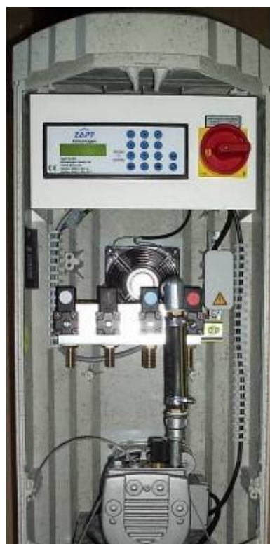
Vue de l'armoire de pilotage externe avec le capot ouvert.
